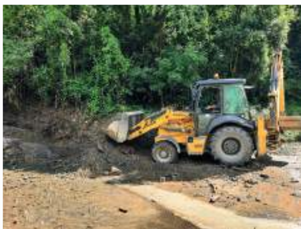
Évacuation des alluvions qui obstruaient la route des vignes
