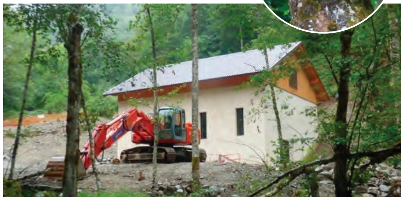
Usine de la microcentrale
